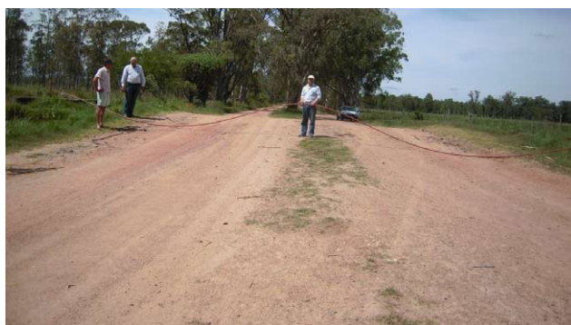
Figura 5-13 Tubo de conexión de sensor de presión diferencial en cruce de avenida. GLENCORE
