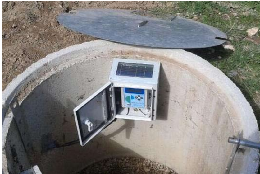
Figura 5-20 Arqueta de caño con ESPAY abierta
