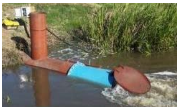
Figura 5-8 Detalle chimenea en Placa de Orificio bombeo GLENCORE
