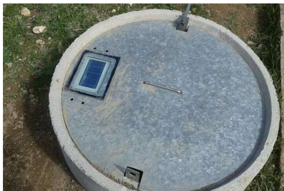
Figura 5-19 Arqueta en caño de hormigón con ventana para ESPAY
