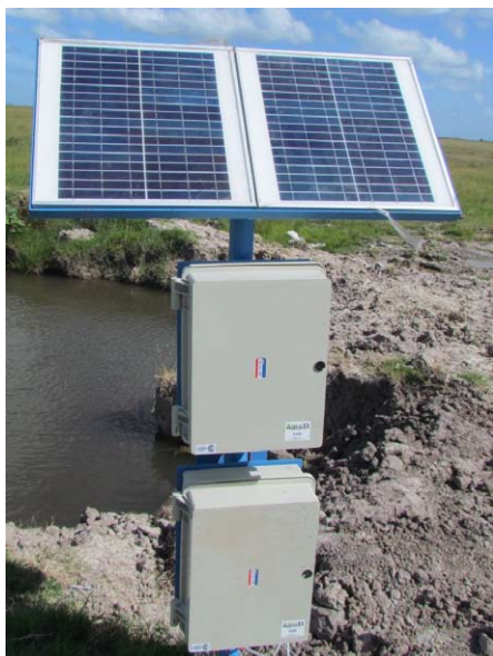
Figura 5-10 Doble panel solar
