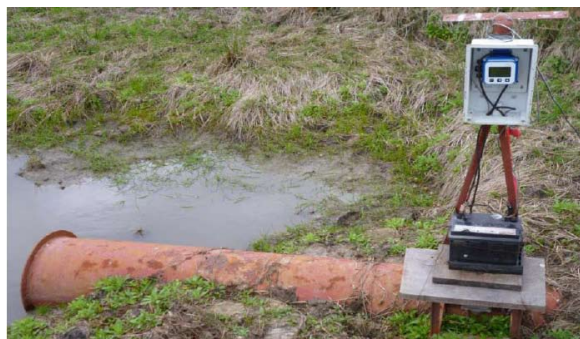
Figura 5-11 Caudalímetro electromagnético con batería
