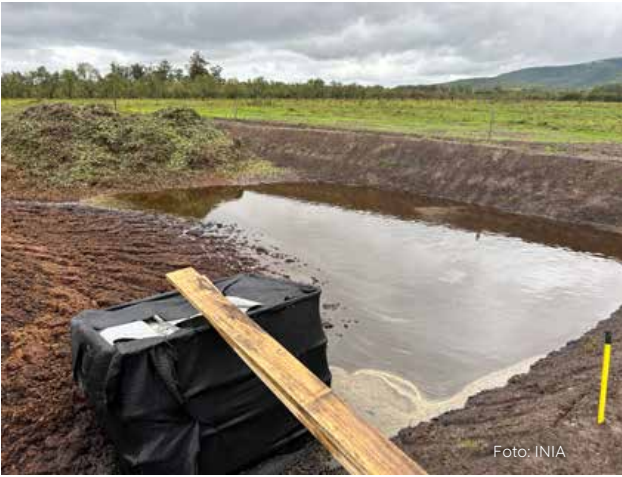
Figura 3 - Pileta de acopio del alperujo, separación de las fases mediante una bomba que se coloca en el tanque de filtrado.
